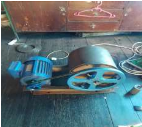
Gambar 7. Tampilan Generator dan Motor Penggerak
